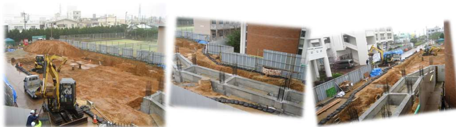
校舎部分の基礎工事の最中です！ 写真右側の本校舎との渡り廊下部分の基礎は完了しております
